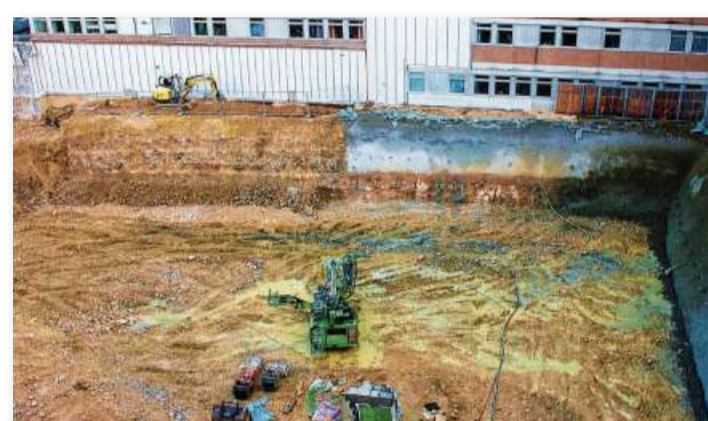
Die Abbrucharbeiten durch die Firma Max Wild GmbH aus Berkheim konnten in den ersten beiden Monaten des Jahres abgeschlossen werden.
